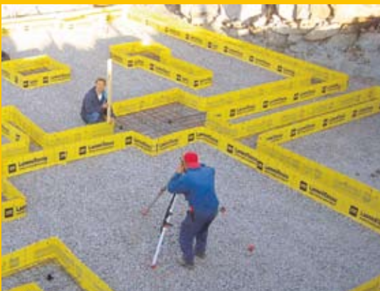
Valmismuotin avulla myös monimuotoisen rakennuksen antura on mahdollista tehdä ja valaa valmiiksi päivässä.
